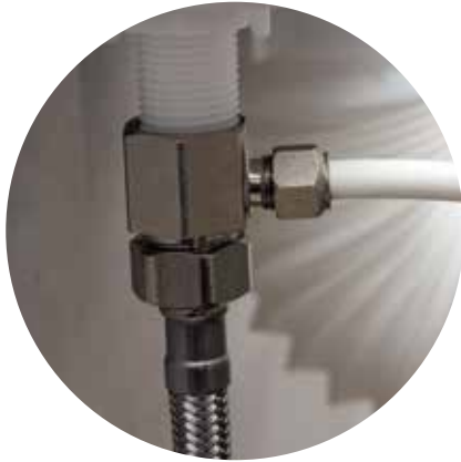
Sistema de acople para la entrada del agua
